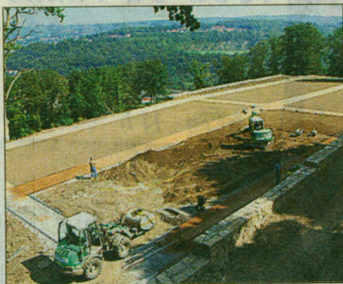
Die Arbeiten laufen im Schlossgarten der Schlossterrassen auf Hochtouren. Foto: V. Bremshey
